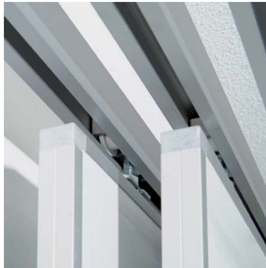
Laufschiene objektbezogen in die Decke eingelassen
