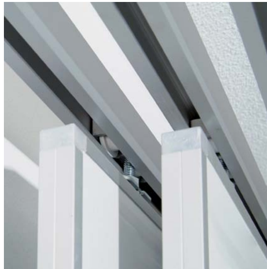
Laufschiene objektbezogen in die Decke eingelassen
